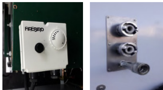
Fig. 5 - Pannello di controllo
